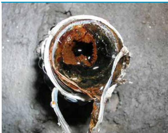
Cijev je skoro začepljena kamencem.
