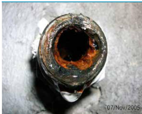
Kamenac je znatno smanjen i cijev je prohodna.
